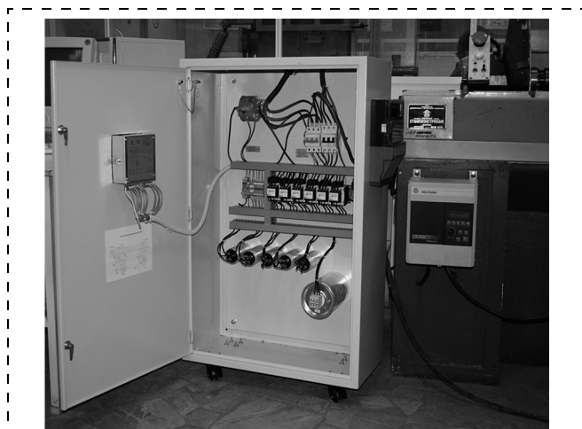
Рис. 3. Общий вид установки АККРМ для токарного станка 16К20Ф3
